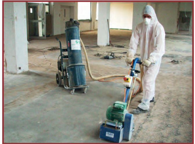
Asbesthaltiger Kleber in Fußböden gehört fachgerecht entsorgt
