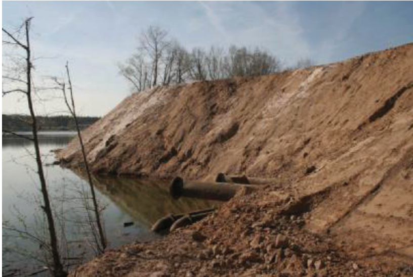
Foto 7: Die Hangbereiche der Aufschüttung können aufgrund des verwendeten Materials nicht in einem Winkel von 90 Grad abgegraben werden.
